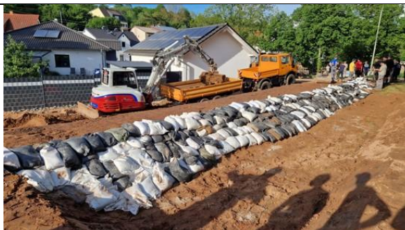
Abbildung 4-25: Provisorische Instandsetzung des Ziegelhüttendamms Höhe Heerstraße nach dem Pfingsthochwasser 2024
