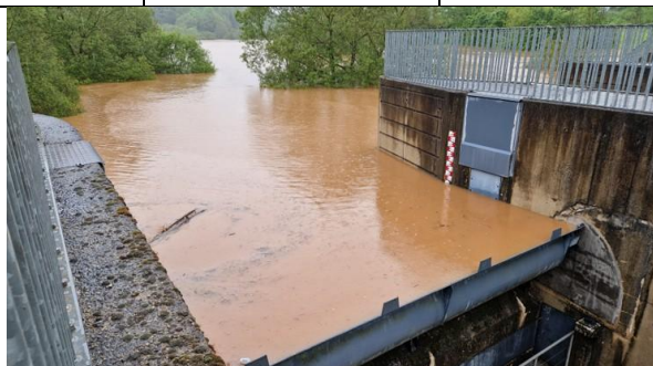
Abbildung 4-24: Hochwasserrückhaltebecken der Blies während des Pfingsthochwassers 2024
